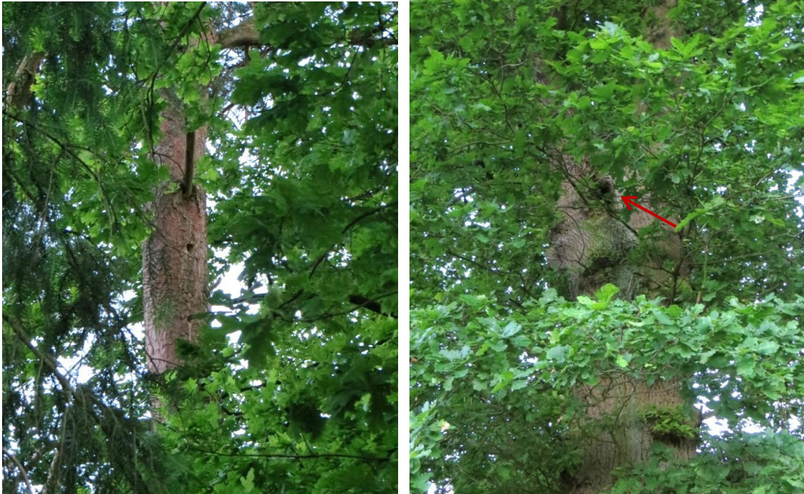
Abb. 3, Abb. 4: Baumhöhlen in älteren Bäumen (Kiefer, Eiche) an einem Grundstück südlich des Hinkenwegs zentral im UG; diese könnten potenziell als Lebensstätten von Abendsegler, Rauhaut- (und Wasser-)Fledermaus dienen (SM, 03.06.2014).
