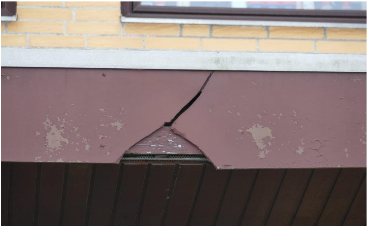
Abb. 6: Ansicht der beschädigten Verkleidung des Dachüberstands an der Verladestation an der Torneestraße (Blickrichtung Süd; Aufnahme vom 03.02.2026).
