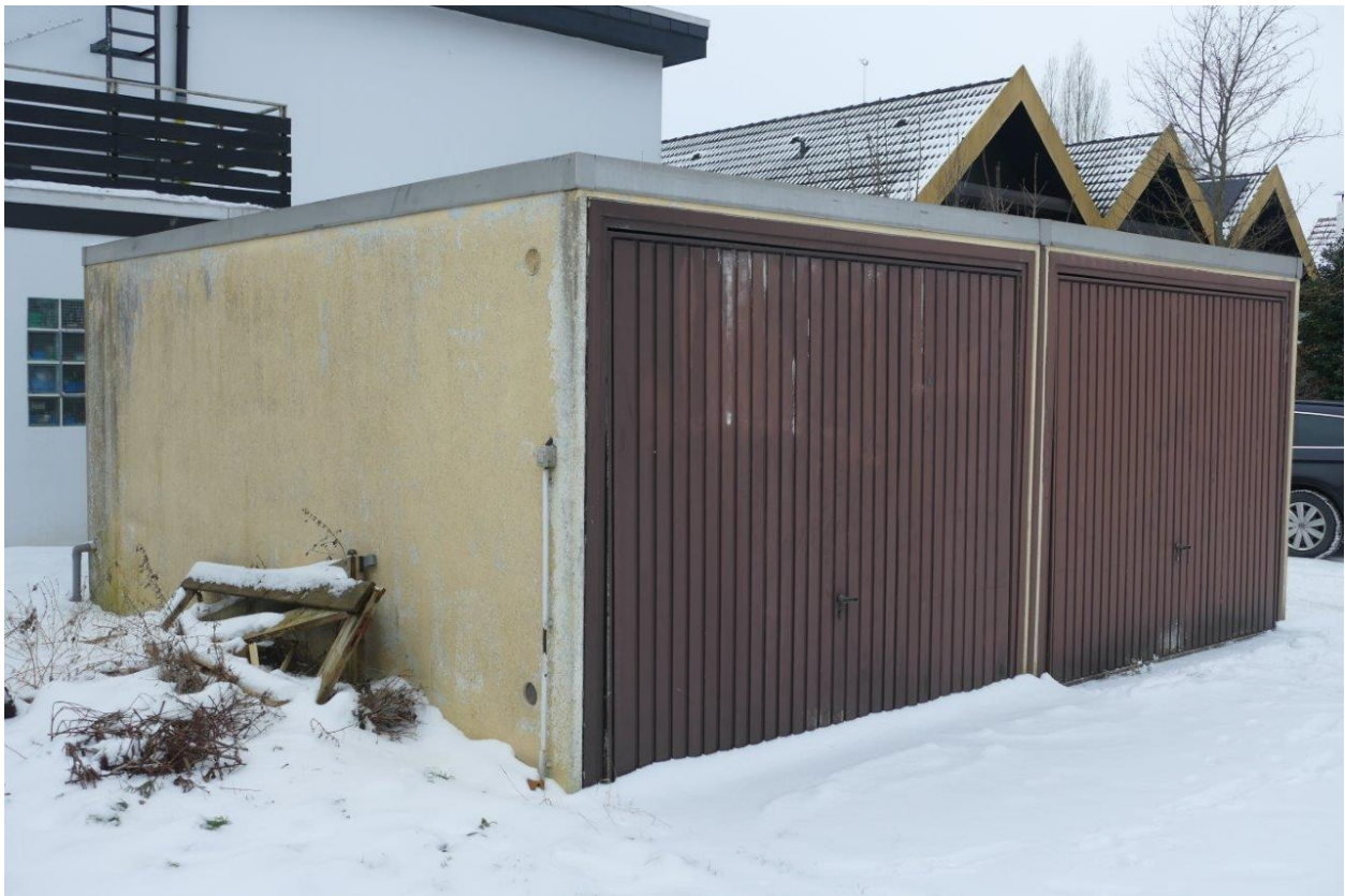
Abb. 14: Blick auf die Doppelgarage – an der Wand links neben dem linken Tor sind die runden Lüftungsöffnungen zu erkennen, die potenzielle Einflugmöglichkeiten für Vögel und Fledermäuse darstellen (Blickrichtung West; Aufnahme vom 03.02.2026).
