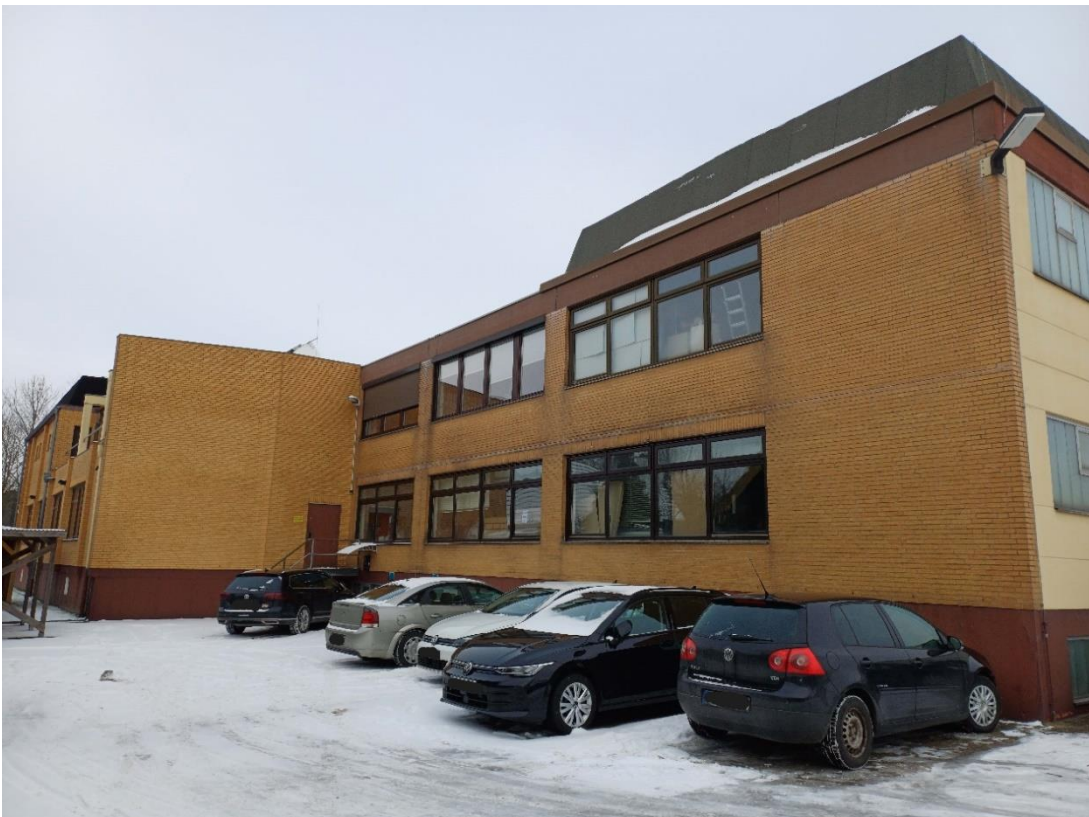
Abb. 2: Ansicht vom Hauptgebäude und dem südlichen Gebäudeflügel des Poliboy-Firmensitzes – im Zwischenraum zwischen der Dachblende beidseits der Gebäudeecke rechts im Bild (oberhalb der Lampe) sowie der Gebäudeaußenwand könnten Fledermausquartiere und Mauersegler-Nistplätze liegen (Blickrichtung Nordwest; Aufnahme vom 03.02.2026).
