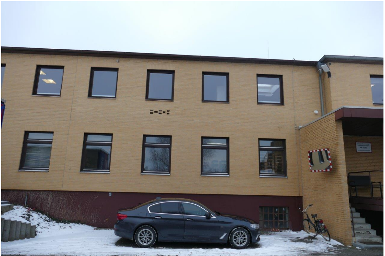
Abb. 3: Lüftungsöffnungen als Einflugmöglichkeiten sind an mehreren Gebäudepartien zu finden, so auch hier an der nördlichen Fassade zwischen Ober- und Erdgeschoss (Blickrichtung Süd; Aufnahme vom 03.02.2026).
