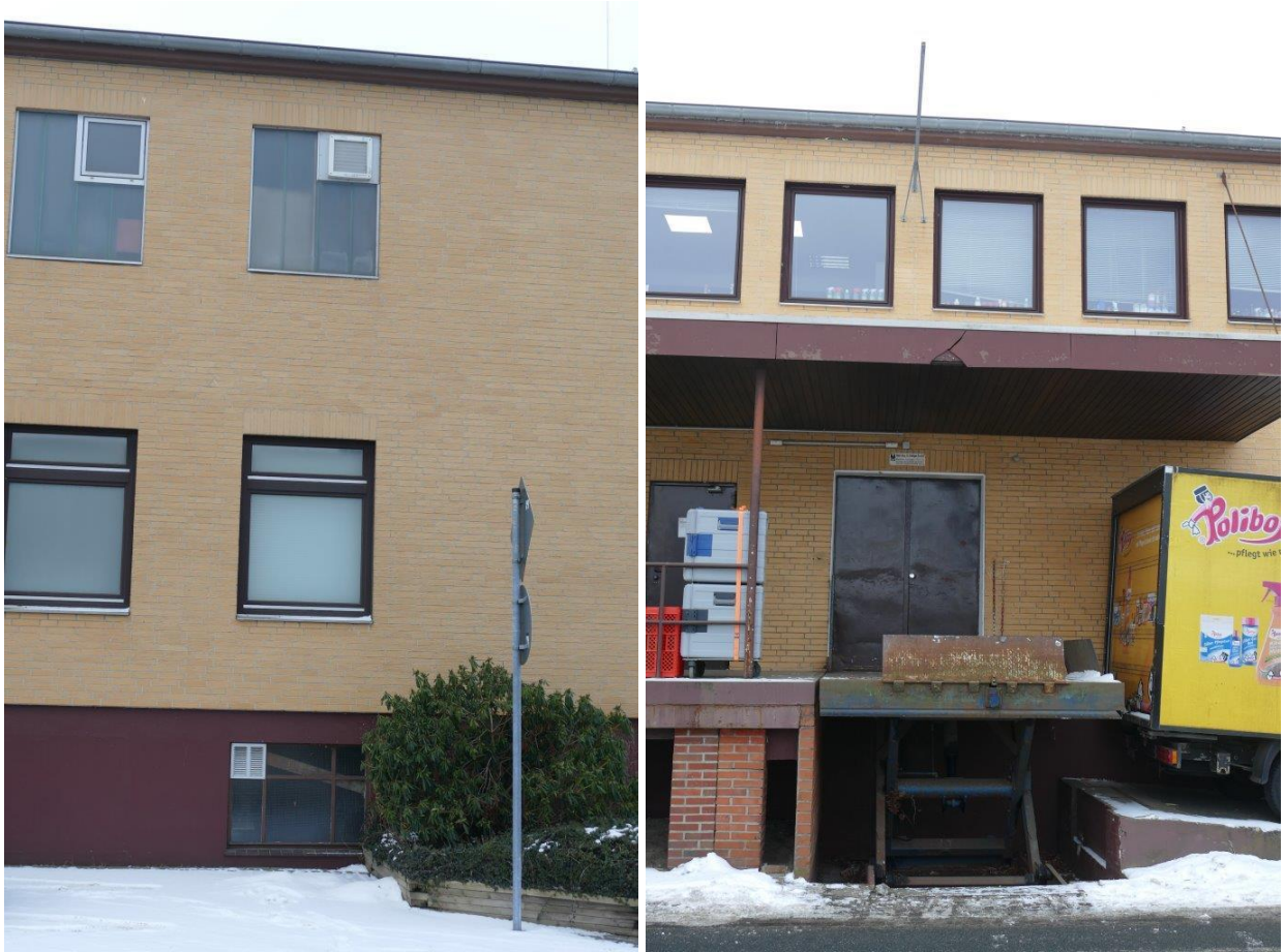
Abb. 5a+b: Blick von der Torneestraße auf die Nordfassade des Poliboy-Gebäudes mit mehreren Lüftungsgittern als potenziellen Einflügen (links) bzw. die Verladestation mit beschädigtem Dachüberstand (rechts; beide Aufnahmen Blickrichtung Süd, vom 03.02.2026).
